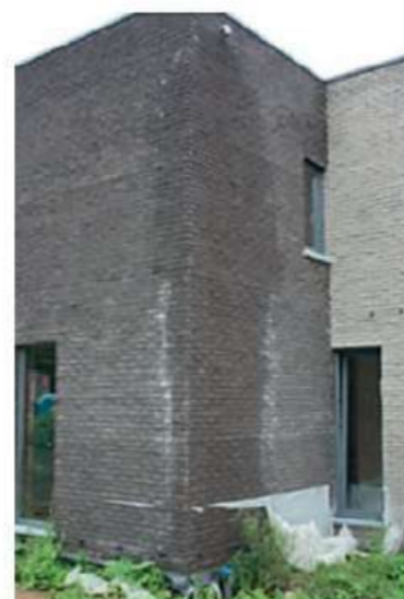
Fig. 6: Ontbreken van voorlopige waterafvoer dak
